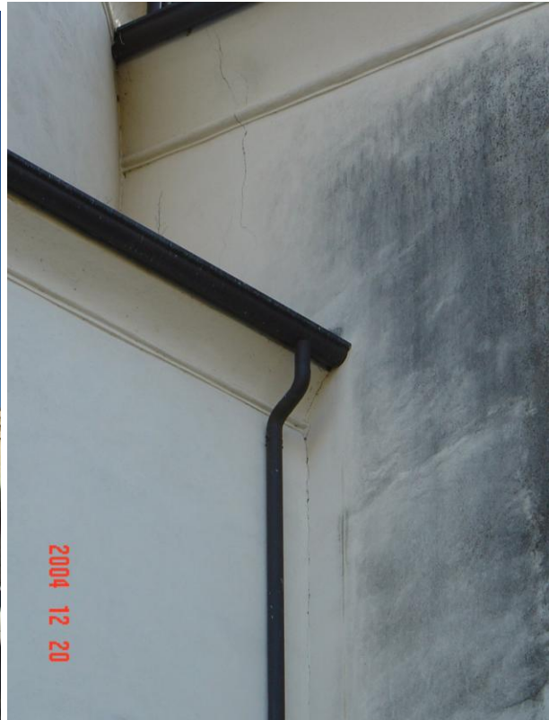
evidenti segni lato Nord (in alto)
